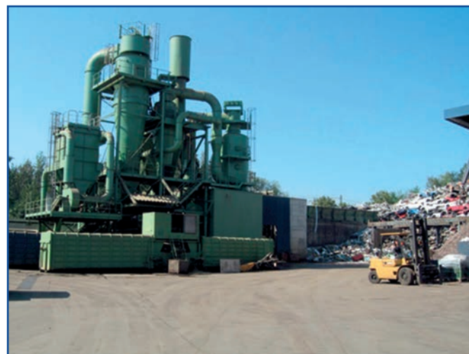
Фото 5. Шредерная установка с системой очистки отработанного воздуха
