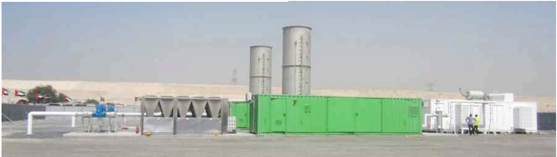
Большая газовая установка в Арабском регионе, температура окружающей среды >45°C на протяжении продолжительных периодов, производительность 6000 м 3 /ч. Слева направо: газовые фильтры, устройство сушки газа (чиллер), установка предварительной очистки и закачки, пульт управления, ВТ сжигание на свечах и ТЭС. На заднем фоне полигон ТБО 50 Га
